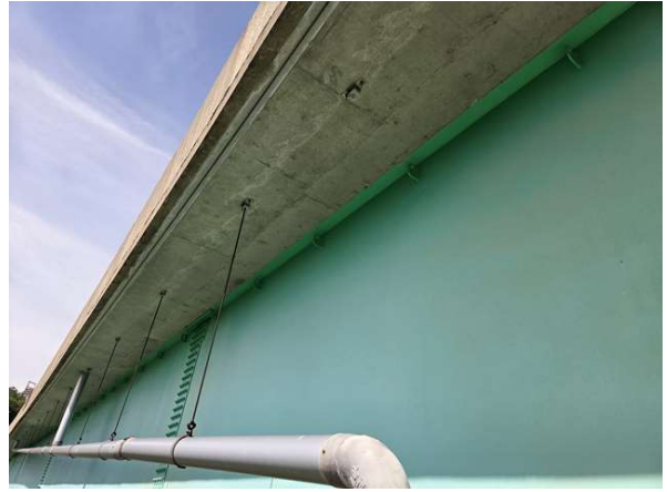
배수관 행거로이드 탈락
